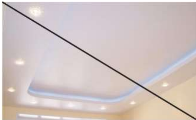
Плохо Многоуровневые гипсокартонные конструкции
