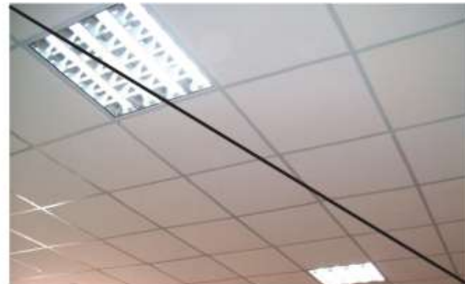
Плохо Открытые направляющие
